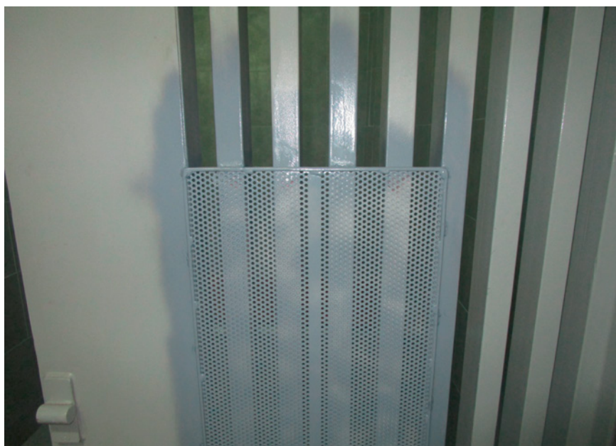
Puertas de la Comisaría de Calatayud (Zaragoza), con barrotes y chapa metálica que podría utilizarse para autolesionarse
